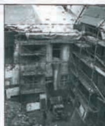
Völlig marode war die Baustelle: 1987 wurde heftig saniert.
